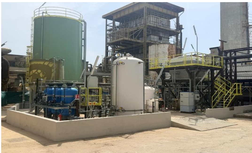
Impianto trattamento reflui Area Ovest
