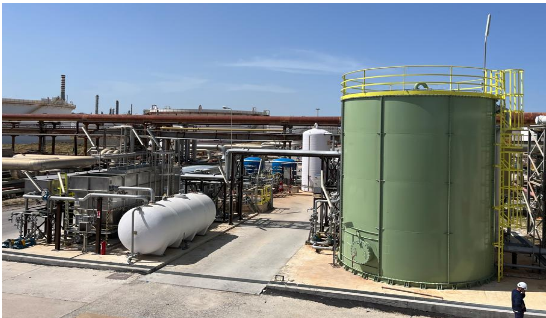
Impianto trattamento reflui Area Est
